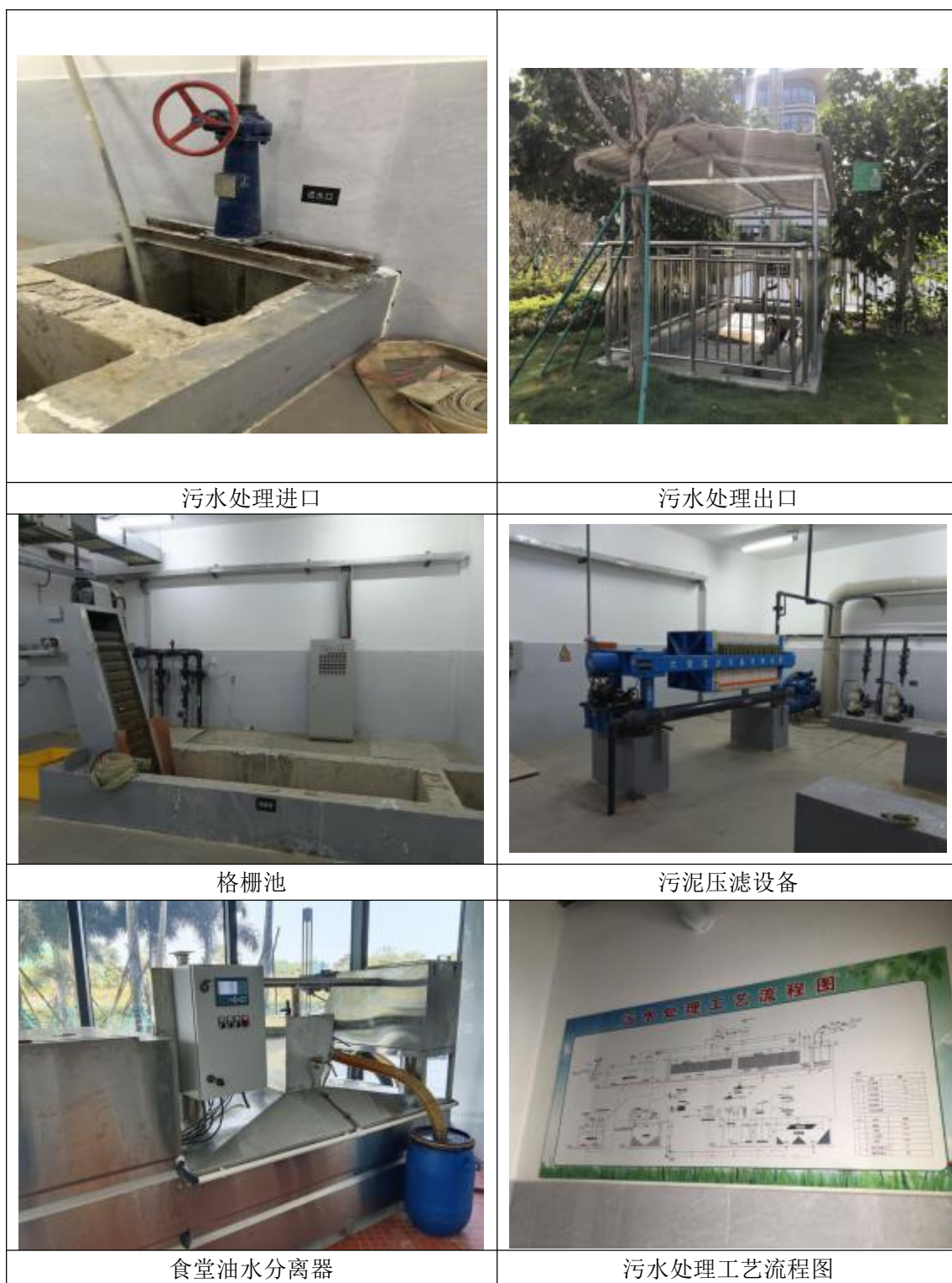
图 5.1-2 废水治理环保设施
